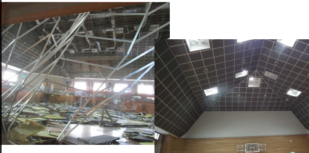
メインアリーナのシステム天井が全面脱落した サブアリーナは脱落なし（写真：益城町提供）
