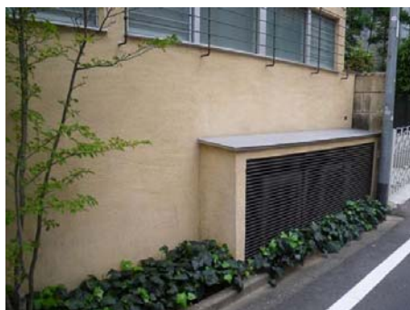
室外機置き場を建物に取り込み、吹き出し口にルーバーを取り付けて景観に配慮
