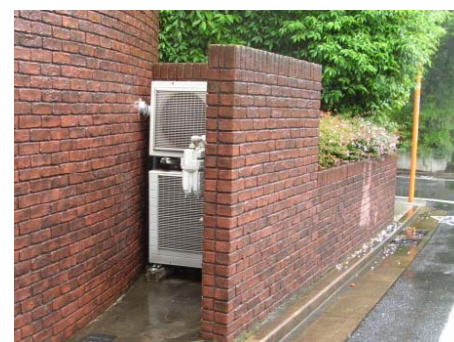
室外機とガスメーターを建物外壁と一体となる塀で隠し、通りからの視線に配慮
