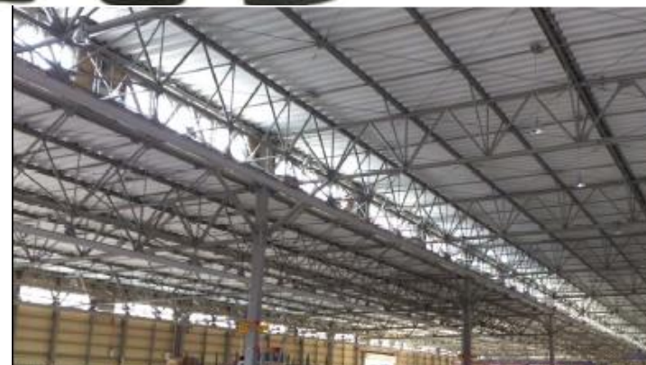
【昼間の太陽光を利用した照明消灯の事例】
