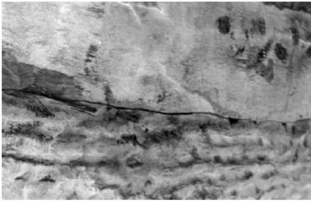
图2 主蒸汽管裂纹形貌
