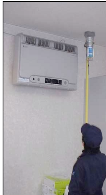
【消防設備検査】自動火災報知機の例
