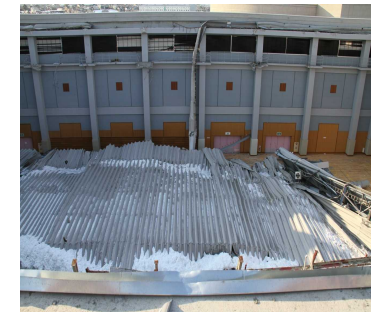
体育館の屋根崩落被害(埼玉県)
