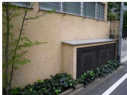
室外機置き場を建物に取り込み、吹き出し口にルーバーを取り付けて景観に配慮
