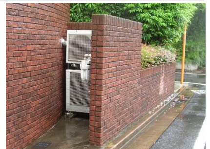
室外機とガスメーターを建物外壁と一体となる塀で隠し、通りからの視線に配慮
