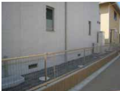
メッシュフェンスで室外機が見える 良くない事例
