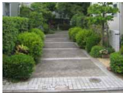
共有部の舗装材が破損している
