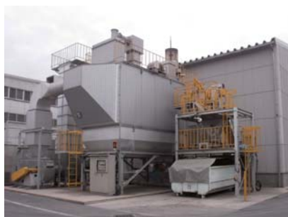
図32 バイオマスボイラー
