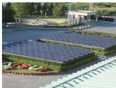
図33 敷地内に敷設した太陽光発電パネル
